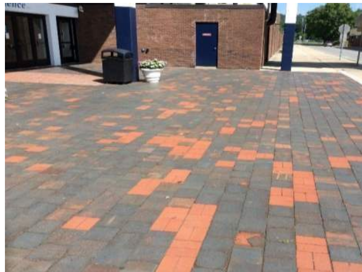
Uneven & Spalling pavers
